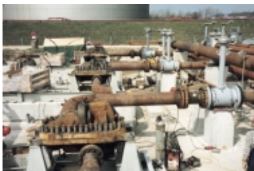
Detailní záběr hlavní čerpací stanice na tankovišti ve Vohburgu. Duben 1995.
