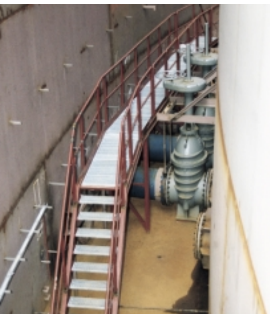
Hlavní armatury v meziprostoru nádrží.
