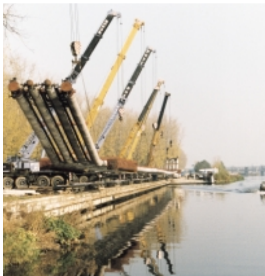
Budování shybky přes Vltavu pro potrubí DN 350 na trase Nelahozeves - Kralupy nad Vltavou.
